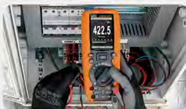
String FV: Medição de Vmpp.
