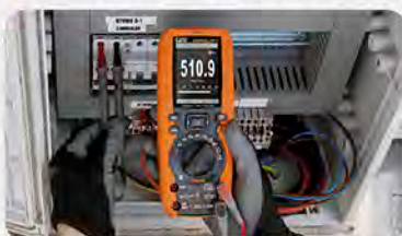
String FV: Medição de Voc.
